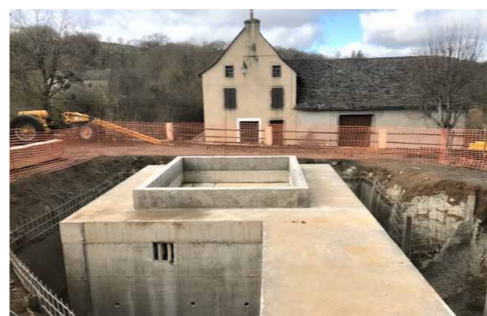
la chaufferie bois : le silo
