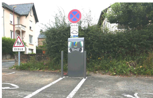
Les bornes de recharge électrique
